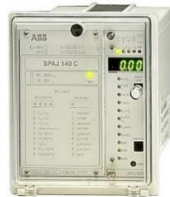
Gambar 7. Relai Proteksi Penyulang Senggiring 3 terpasang Sumber : Aset Jaringan Distribusi PT. PLN (Persero) Area Pontianak 2016
